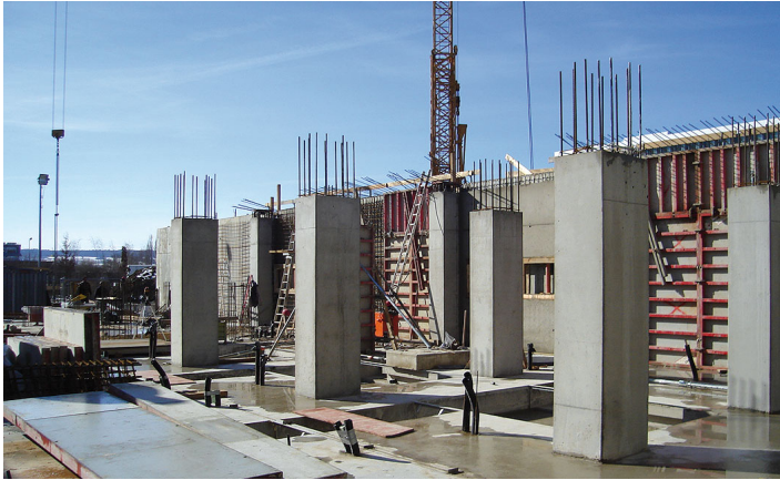
Bodenplatte und Drucktischstützen
